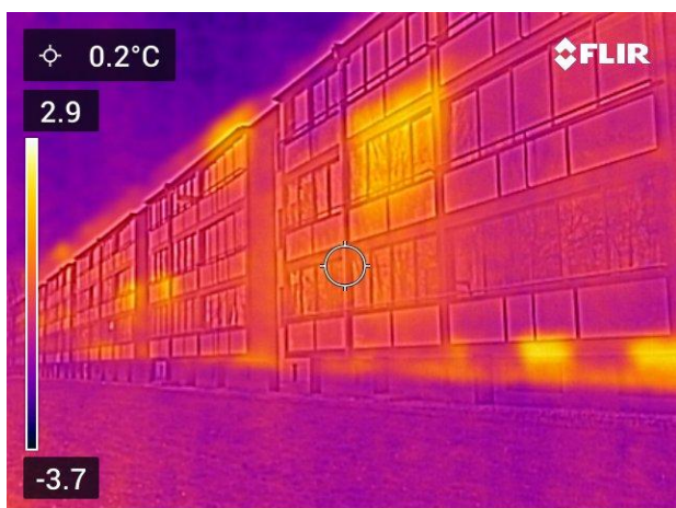
4.10 Morsom illustration, hvor det tydeligt kan ses at der er lejligheder, som ikke har lukket døren fra stuen til altanen (de gule områder viser højere temperatur).
