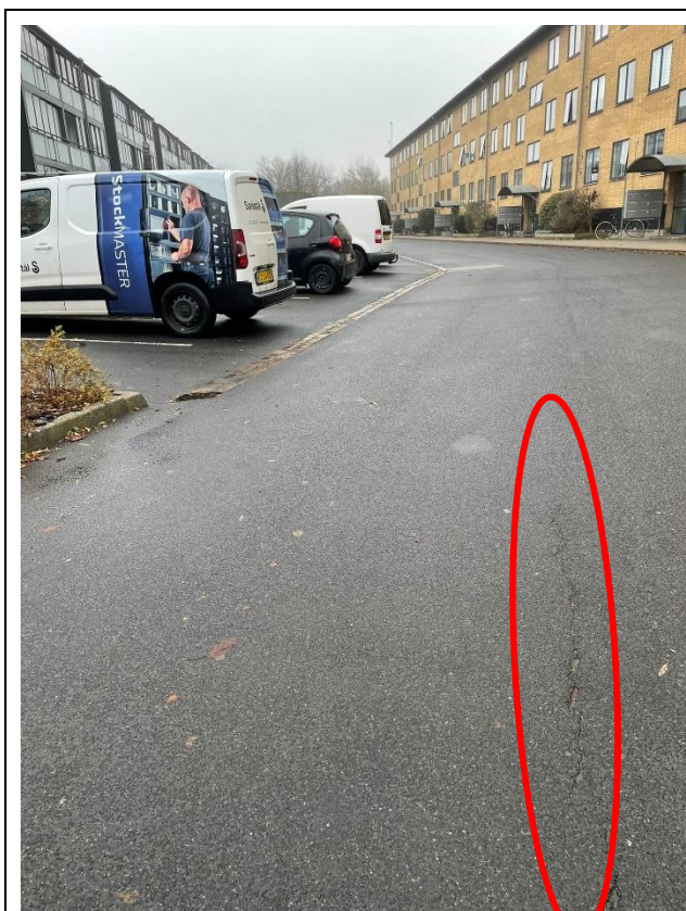
26.4 Revner skal forsegles.
