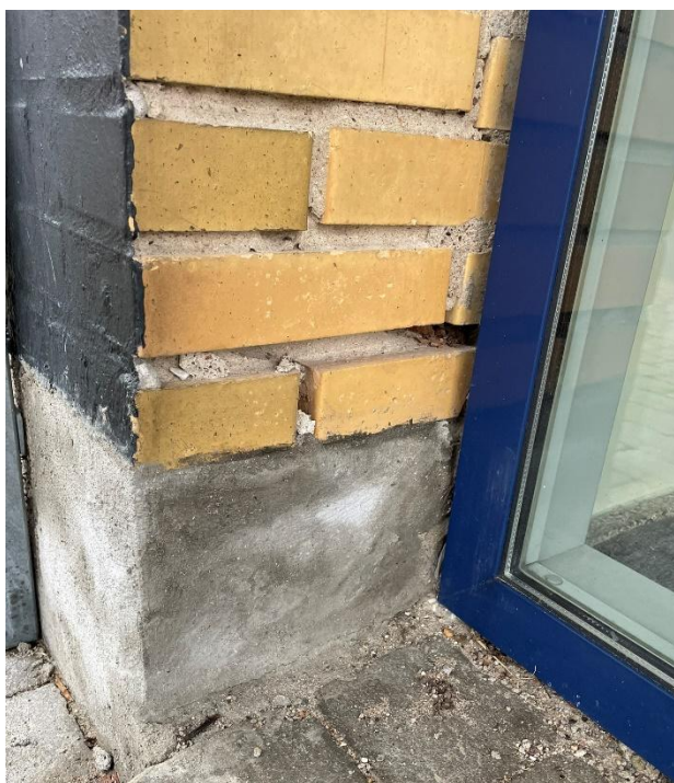
4.3 Saltskadede fuger ved trappedør.
