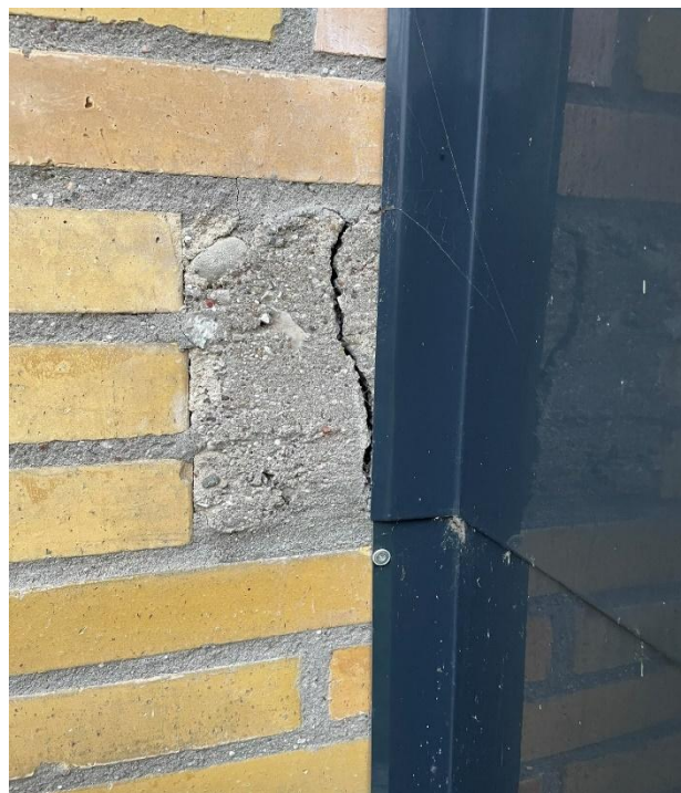
4.2 Revne i betonbjælke over kælderen ved nordvestlige hjørne på blok 3. Revnen skal forsegles, da der kan trænge vand ind til armeringen og medføre omfattende skade.
