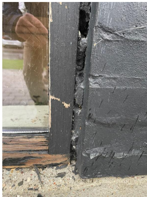
13.1 Mørtelfuger omkring kældervinduer af træ. Fugerne er defekte og udskiftes til silikonefuge.
