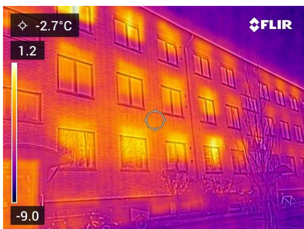
4.8 Termofoto af østvendt facade (mod parkeringsplads) viser at der er betydeligt varmetab både gennem de ringe isolerende vinduer og gennem facaden med sparsom isolering.
