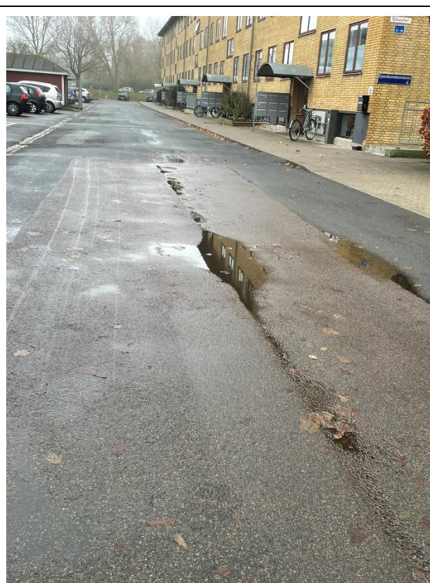
26.1. Lunker med vandpytter oprettes med asfalt når man synes de er for store.
