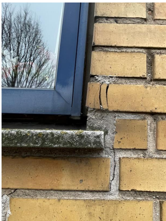
14. Ved en del af sålbænkene er der revner i mursten og huller i mørtel ved indmuringen, som skal udbedres.
