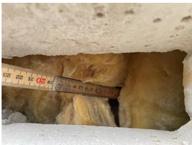
4.6 Der er kun 75mm isolering i hulmuren.
