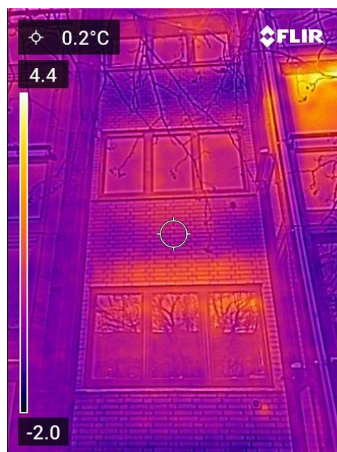
4.9 Termofoto ved de nye vinduer mellem altanerne på vestvendt facade, viser hvor meget bedre de nye vinduer isolerer, idet forskellen mellem udetemperaturen og vinduernes overflader er meget begrænset.
