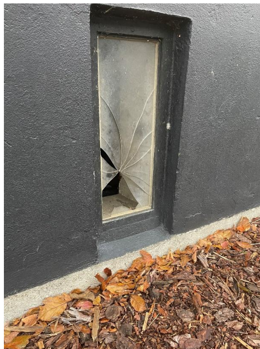
12.1 Små vinduer til pulterrummene. Eksempel flækket rude.
