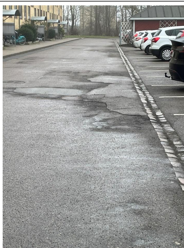
26.5 Når asfaldtbelægningen revner/krakelerer så meget som her (foto er fra blok 3) er det nødvendigt at ophugge de revnede områder, for at komprimere underlaget og udlægge nyt asfalt.
