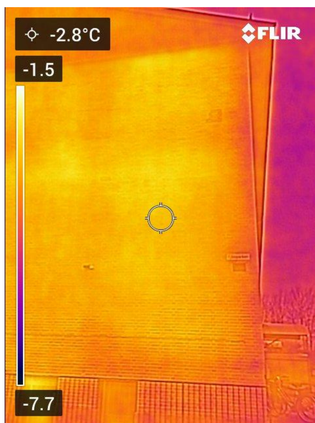
4.7 Termoffoto af gavl viser at der er stort varmetab, idet murens yderside er betydeligt varmere end udetemperaturen.
